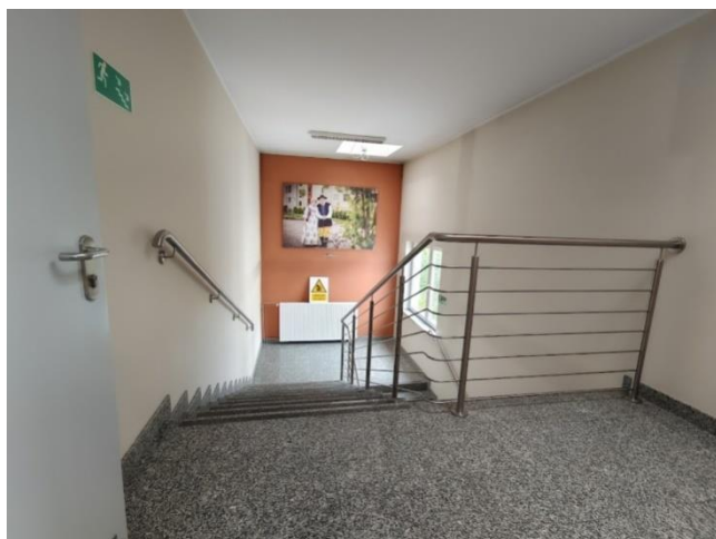
Zdjęcie nr 2: Klatka schodowa na której brak jest poręczy na dwóch wysokościach.
