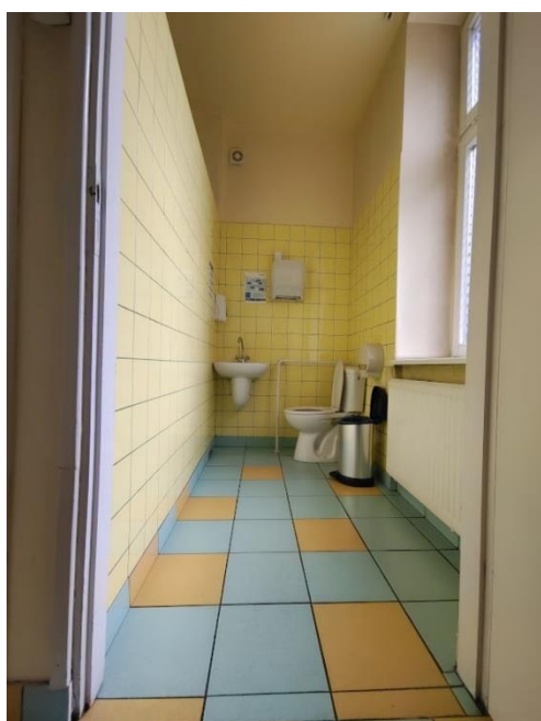
Zdjęcie nr 3: Toaleta. Stan techniczny i jej dostępność nie jest zadowalająca.
