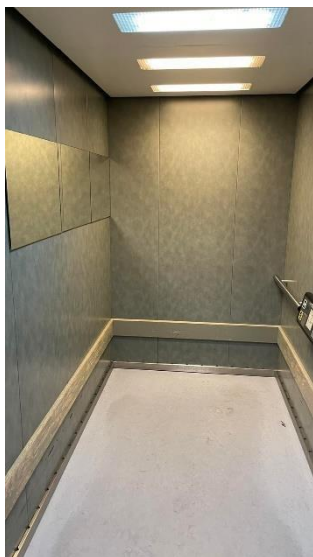
Zdjęcie nr 12: Kabina windy
