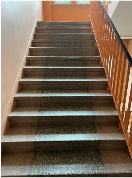
Zdjęcie nr 9: niedostosowane schody
