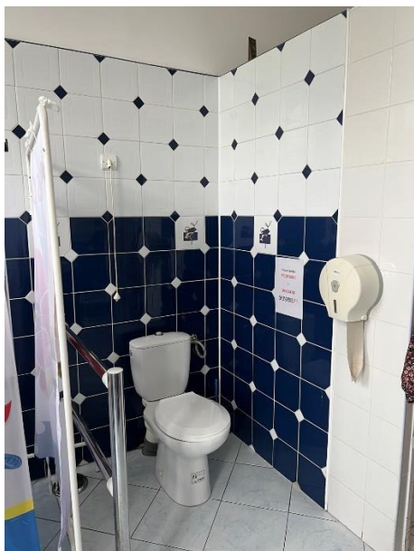
Zdjęcie nr 7: toaleta na oddziale wymagająca remontu
