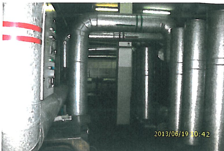
Rysunek 4 Pomieszczenie głównego węzła cieplnego
